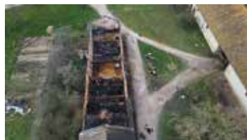
Le bâtiment endommagé aux Dombes
